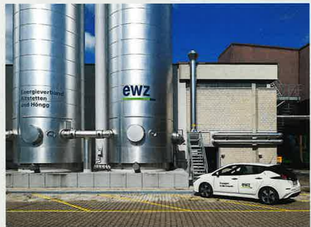
Fig. 1 Energiespeicher, 3 × 175 000 Liter, ca. 75 bis 95 °C.
