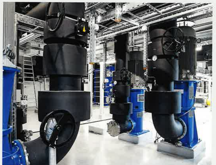
Fig. 3 Entnahmepumpe Abwasser 655 m 3 /h.
