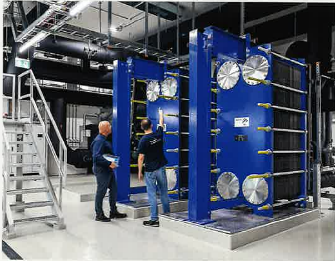
Fig. 2 Plattentaucher Abwärme aus Abwasser 5,5 MW.
