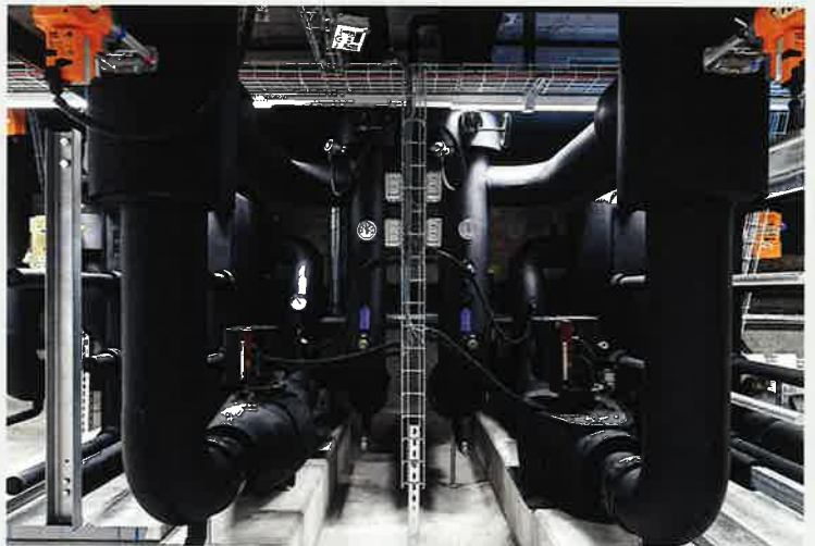
Fig. 3 Anergieleitung für den Energieverbund Escherwiese.
