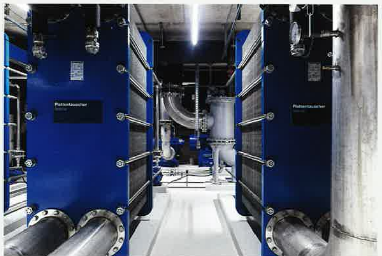
Fig. 2 Plattentaucher, 3 \times 2400 \text{ kW} (Seewasserzentrale Energieverbund Escherwiese).
